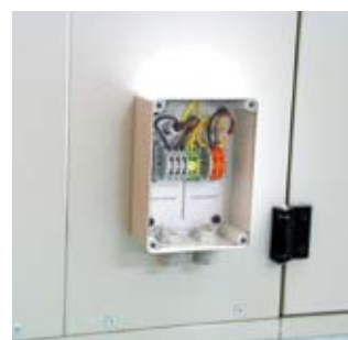
instalacja elektryczna zakończona puszką
